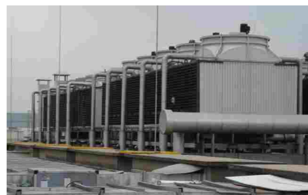
Системы вентиляции/кондиционирования и водоснабжения
